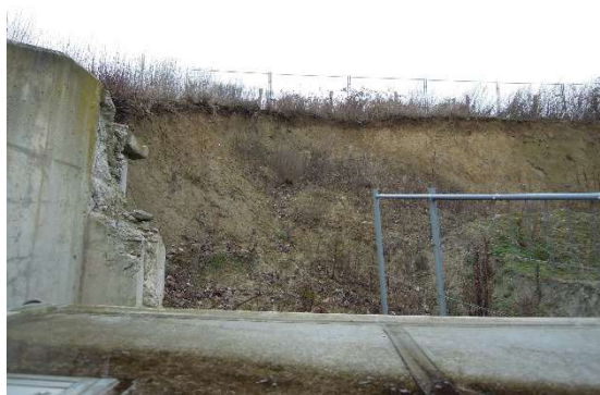
Abbildung 20: Abgerutschter Böschungsbereich unterhalb des Wanderweges, eigenes Foto vom 23.01.2020
